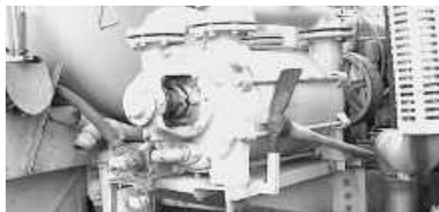
Figure 9. Pompe à anneau liquide dont le garde-protecteur situé au-dessus de la poulie d'entraînement a été enlevé
