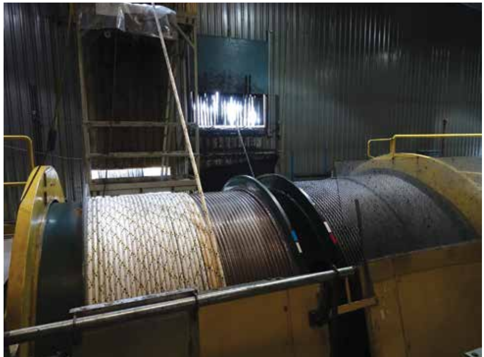
Tambours de machine d'extraction du puits 1 de la mine Goldex
