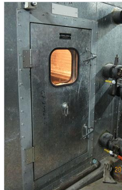
Plénum de ventilation
