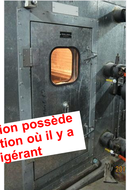
Plénum de ventilation
