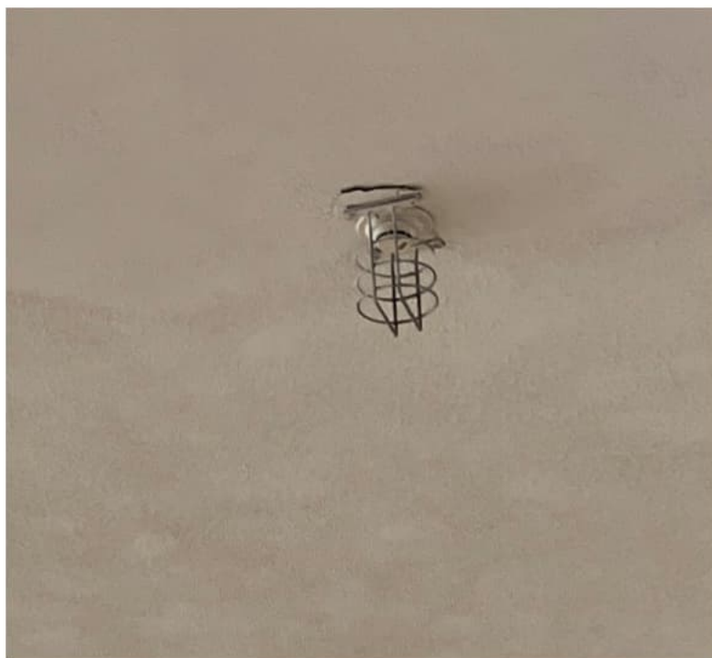
Photo 1 : Décollement du plâtre du plafond du gymnase
