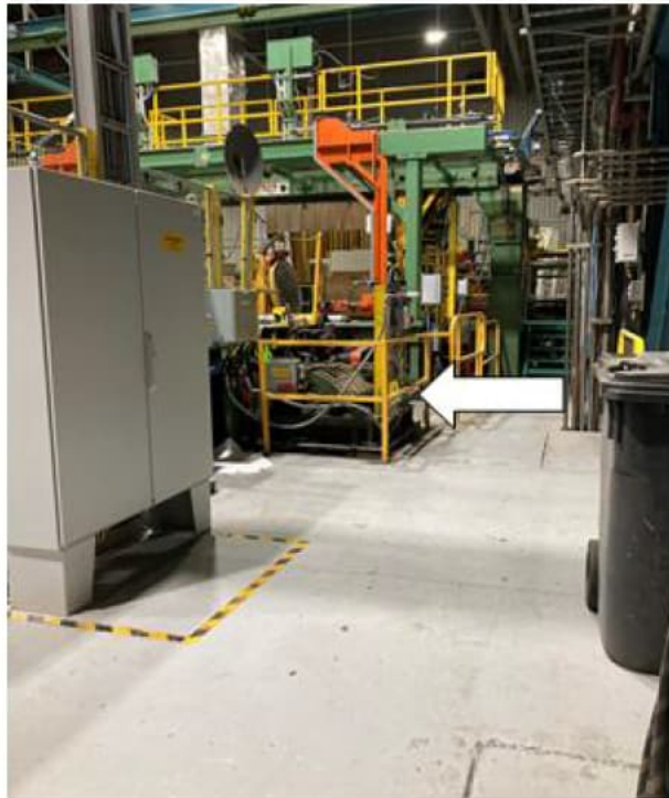
Zone non sécuritaire (garde-corps n'élimine pas l'accès) Source CNESST
