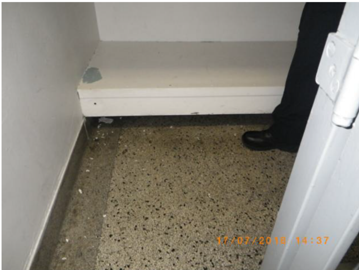
Photo 2 : Banc présent dans les cellules du quartier cellulaire. Source : CNESST, 17 juillet 2018.
