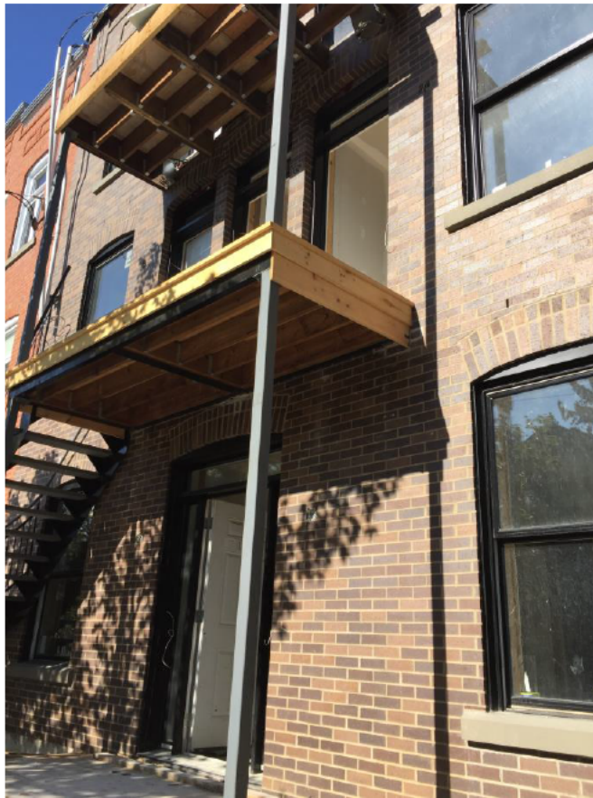
Photo 1. Une vue de la façade avant du bâtiment. Balcons sans garde-corps.
