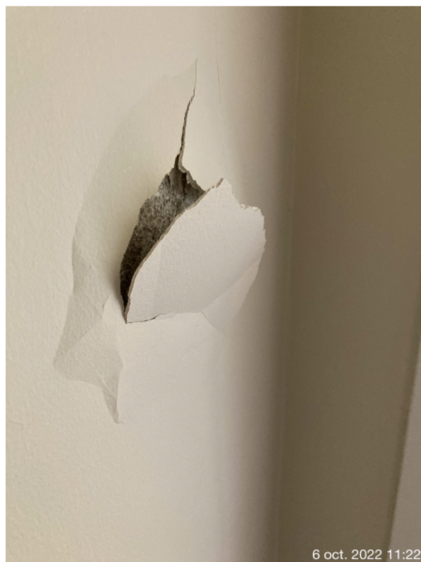
Fissuration et détachement d'un morceau de plâtre (app. [REDACTED]) Source : CNESST
