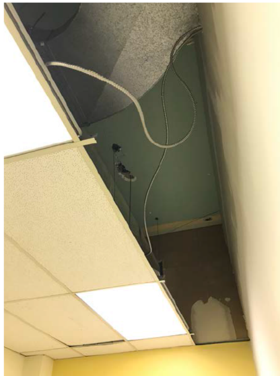
Photo 1 : Plafond du local 317
