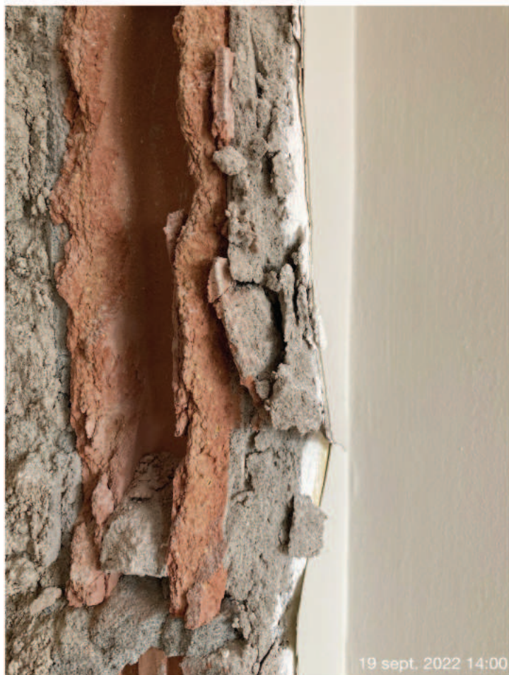
Plâtre et cimentaire sur terracotta (mur), App. [REDACTED] Source : CNESST
