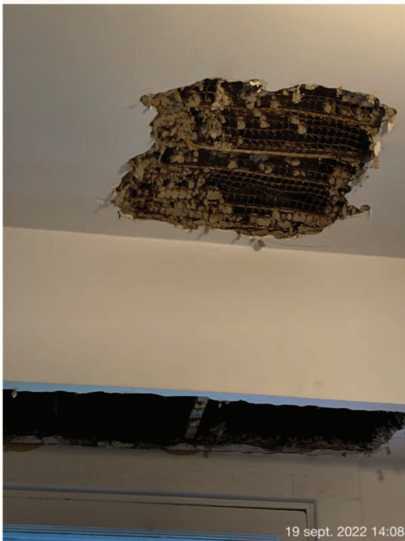
Crépi cimentaire sur treillis métallique (plafond), App. [REDACTED] Source : CNESST
