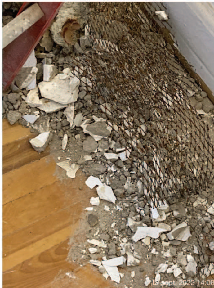
Débris de plâtre et de cimentaires au sol, App. [REDACTED] Source : CNESST
