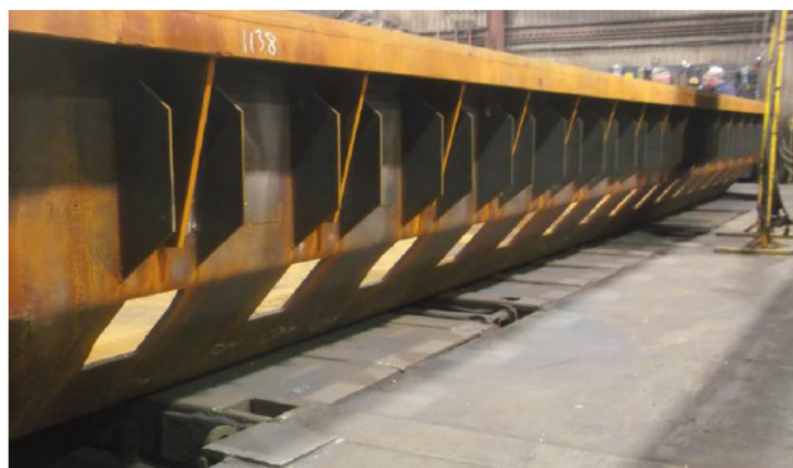
Photo : Ouverture sur le caisson où sont disposés les crochets des brins des élingues. Source : CNESST
