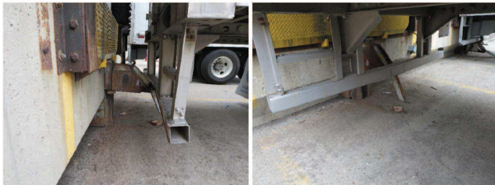
Photos 12 et 13 : Blocage du dispositif de retenue au quai n° 183 Source : CNESST
