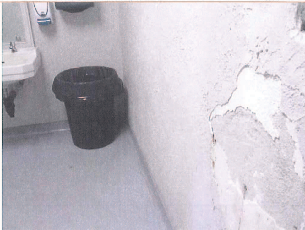
Photo 7 – Salle de bain RDC (Présence d'amiante dans le plâtre des colonnes).
