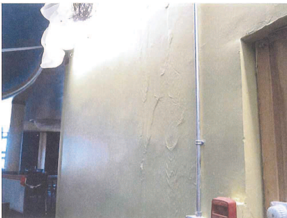
Photo 4 – Salle de Bal 3 e étage (plâtre d'amiante)
