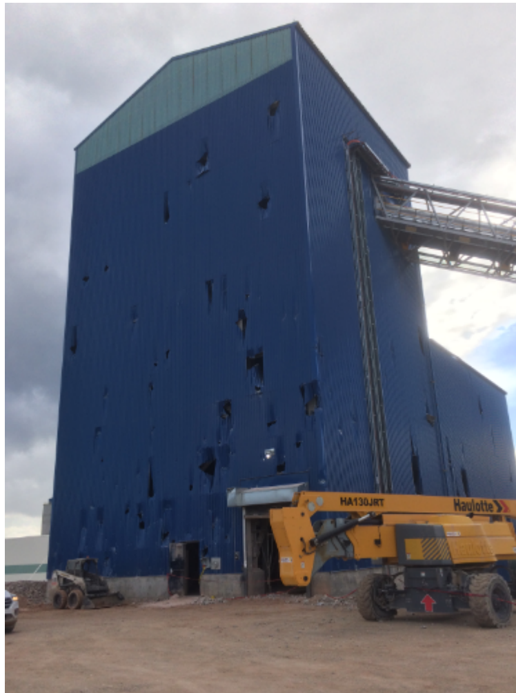
Photo #1 – Bris au bâtiment du concasseur secondaire (source : CNESST)
