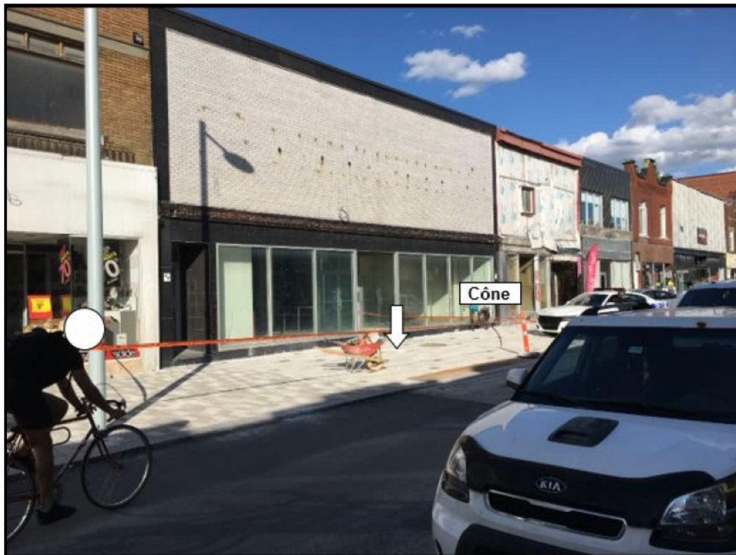
Photo 1 Aperçu des lieux de l'accident. La flèche indique l'emplacement du puits d'aération autour duquel sont exécutés les travaux de chanfreinage. (Source : CNESST)
