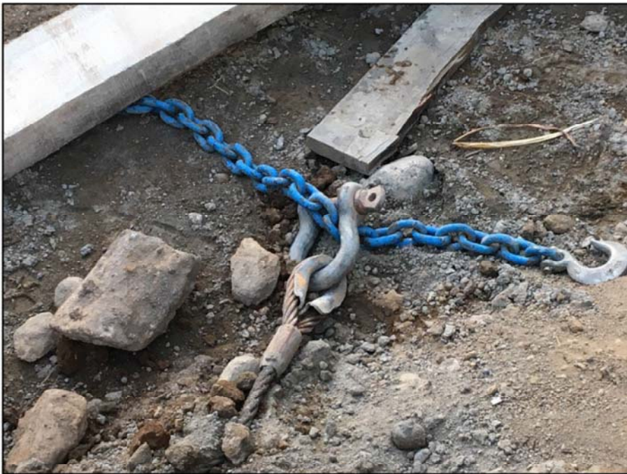
Photo 6 : Manille au bout du câble d'acier (Source : CNESST)
