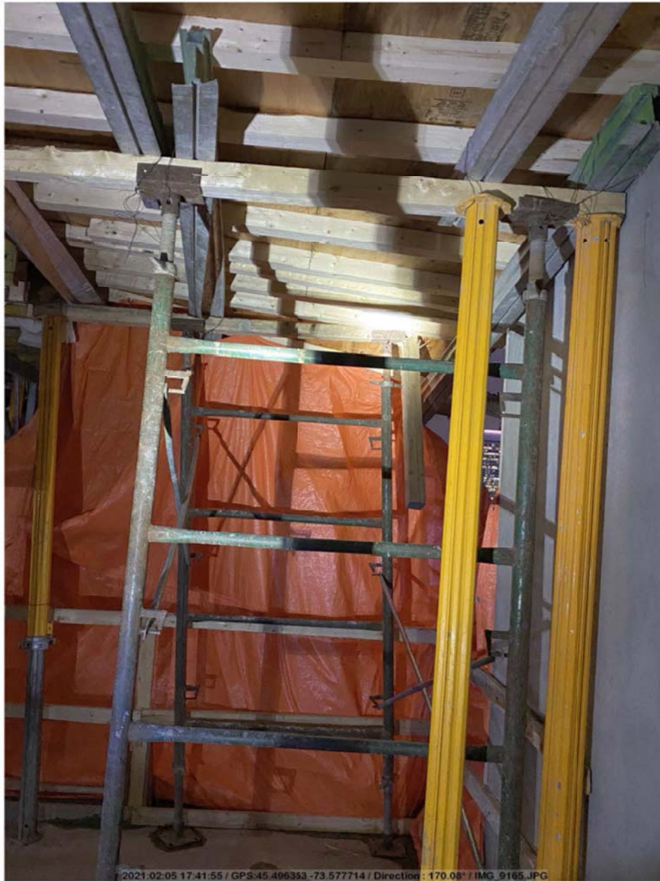
Photo 2 : Système d'étalement conventionnel sous l'effondrement et longeron de bois
