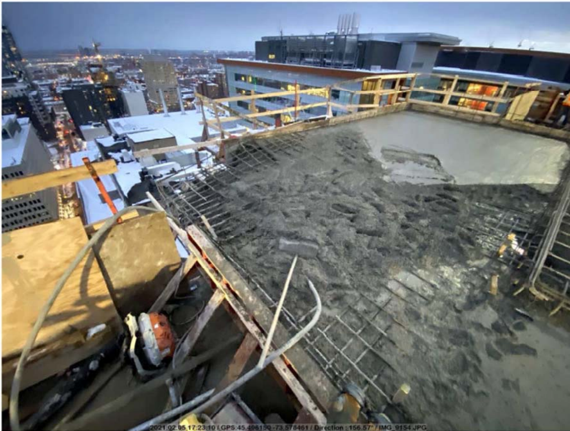
Photo 1 : Zone de l'extension Sud du toit effondré sur le versant EST (source : CNESST)
