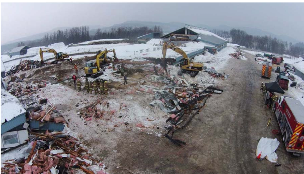
Photo 1 : Vue du bâtiment agricole, après l'effondrement. (Source : CNESST)
