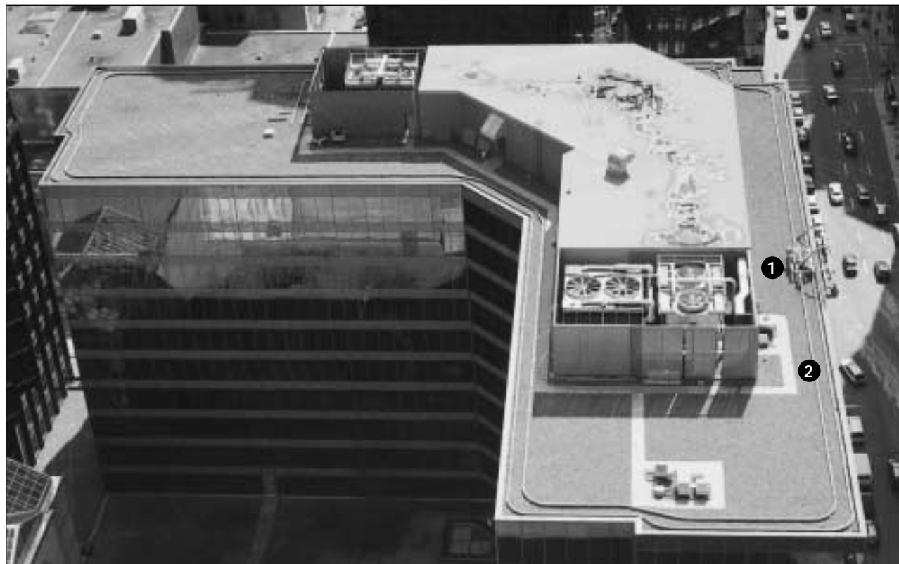
Cabine de toit montée sur rails
