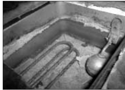
Figure 4 Réservoir d'eau d'un humidificateur en mauvaise condition
