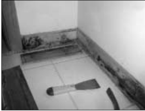
Figure 3 Moisissures visibles à l'œil nu à la base des murs
