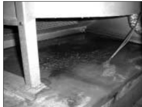
Figure 5 Eau stagnante dans une unité de ventilation
